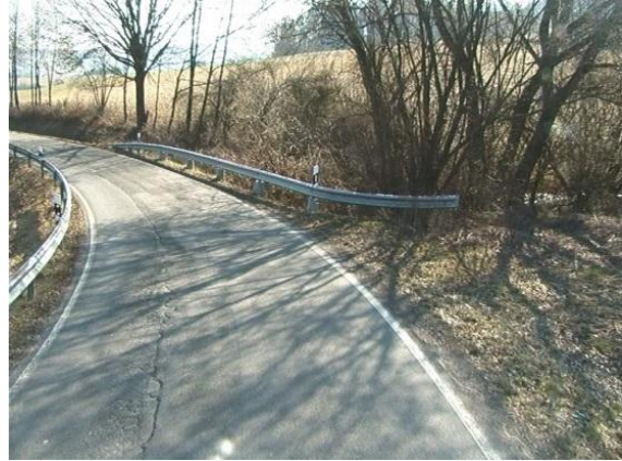
Abb. 4 gerissene Fahrbahndecke mit Verdrückungen
